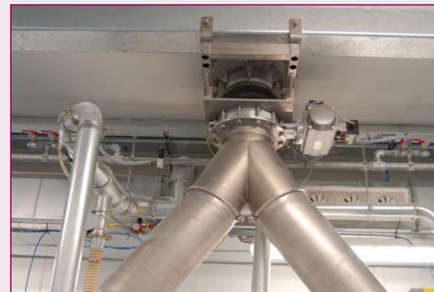
Doseerklep onder het bordes, met dubbele aanvoerpijp naar de tabletteer-machine.
