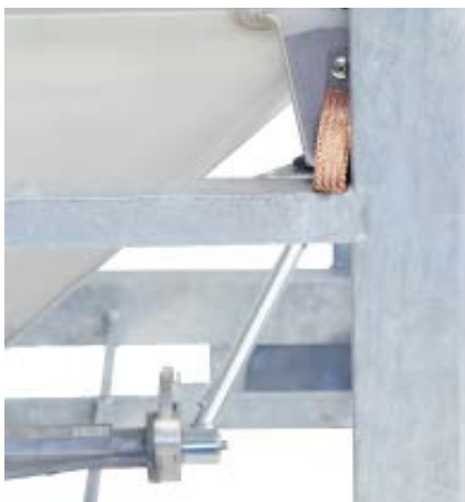
Potentialausgleich zwischen Behälter und Schutzrahmen
